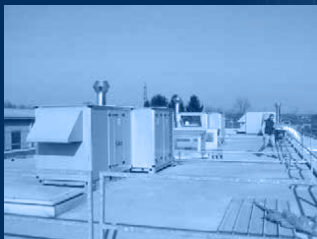
vista unità n°1\2\3/units n°1\ 2\ 3/ view
