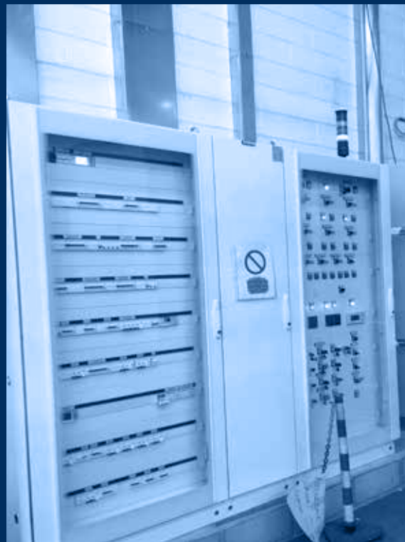
vista quadri centrale potenza e centrale elettronica /power panel and electronic panel view
