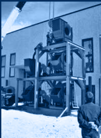
struttura e ventilatori in fase di montaggio / structure and fans assemblage's phase
