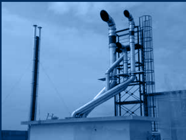
struttura e ventilatori / structure and fans
