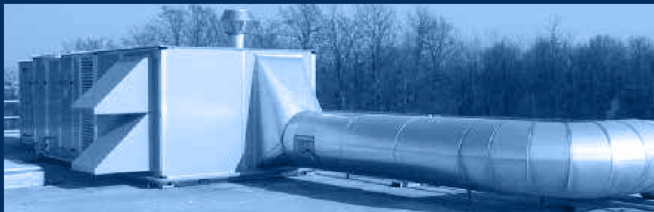
vista frontale unità n°3: canalizzazione mandata aria coibentata con finitura alluminio /front view unit n°3: air delivery canalization cohibented by aluminium finish
