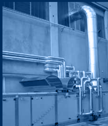
vista UTA sezione camera miscela e distribuzione H2O processo /UTA's mixing chamber and H2O distributions view
