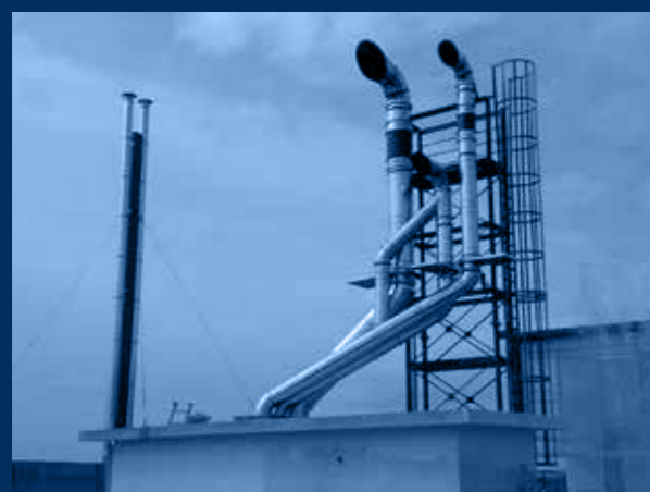
struttura e ventilatori / structure and fans
