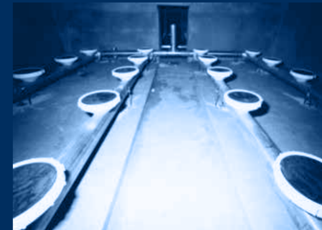
impianto di ossigenazione (aeratori) / oxygenation plant (aerators)
