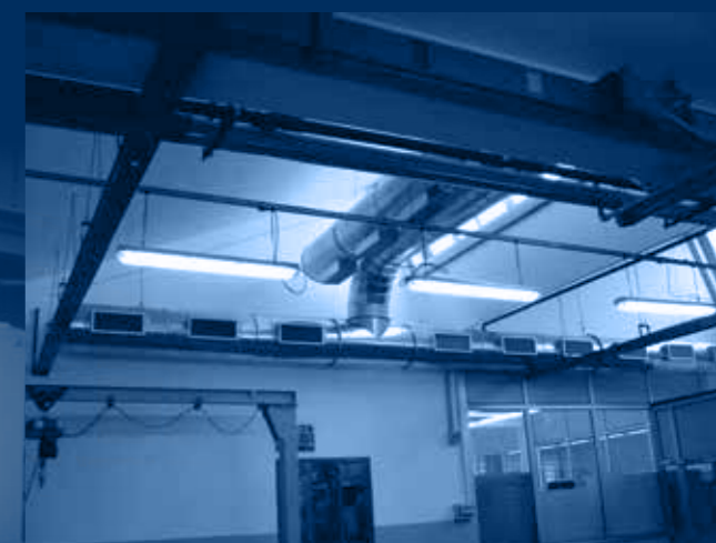
vista interna al reparto con particolare del canale di mandata aria / inside view of the plant with distinctive of the delivery air duct
