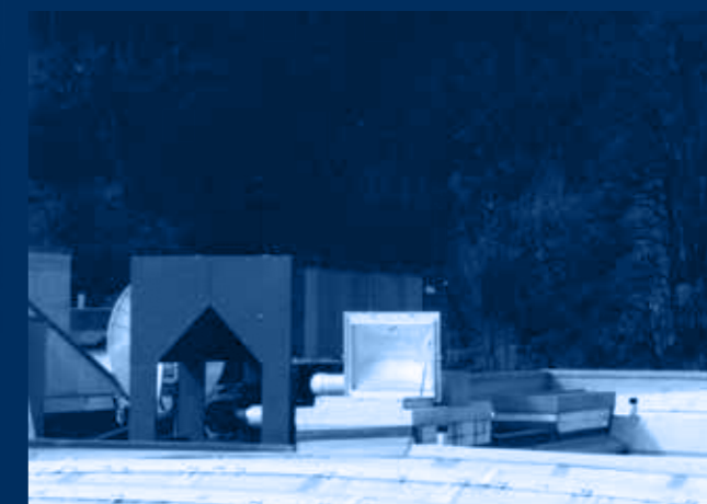
vista refrigeratore in copertura /cooler top view
