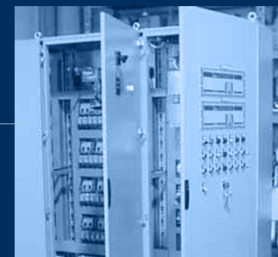
vista quadri elettrici di potenza, comando e controllo UTA/ electrical panels for power, command and control view
