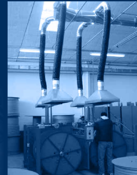
vista particolare cappe di aspirazione / suction hoods detail view
