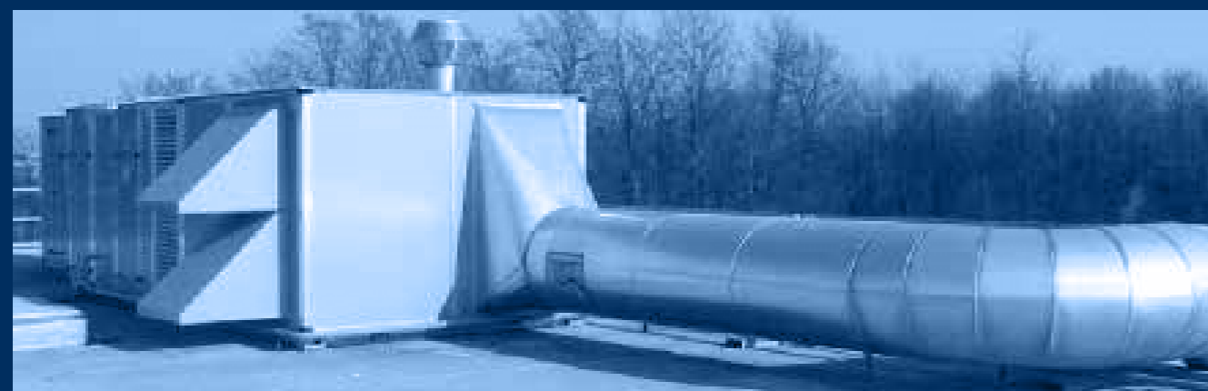
vista frontale unità n°3: canalizzazione mandata aria coibentata con finitura alluminio /front view unit n°3: air delivery canalization cohibented by aluminium finish
