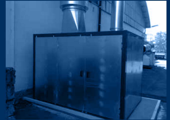
vista box afono ventilatore /soundproofed box view
