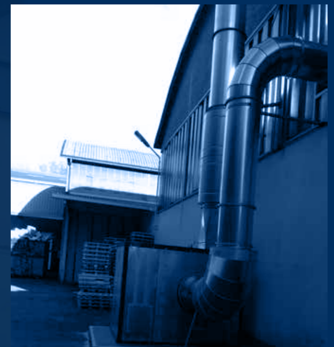
vista box afono e silenziatori / soundproofed box and silencers view
