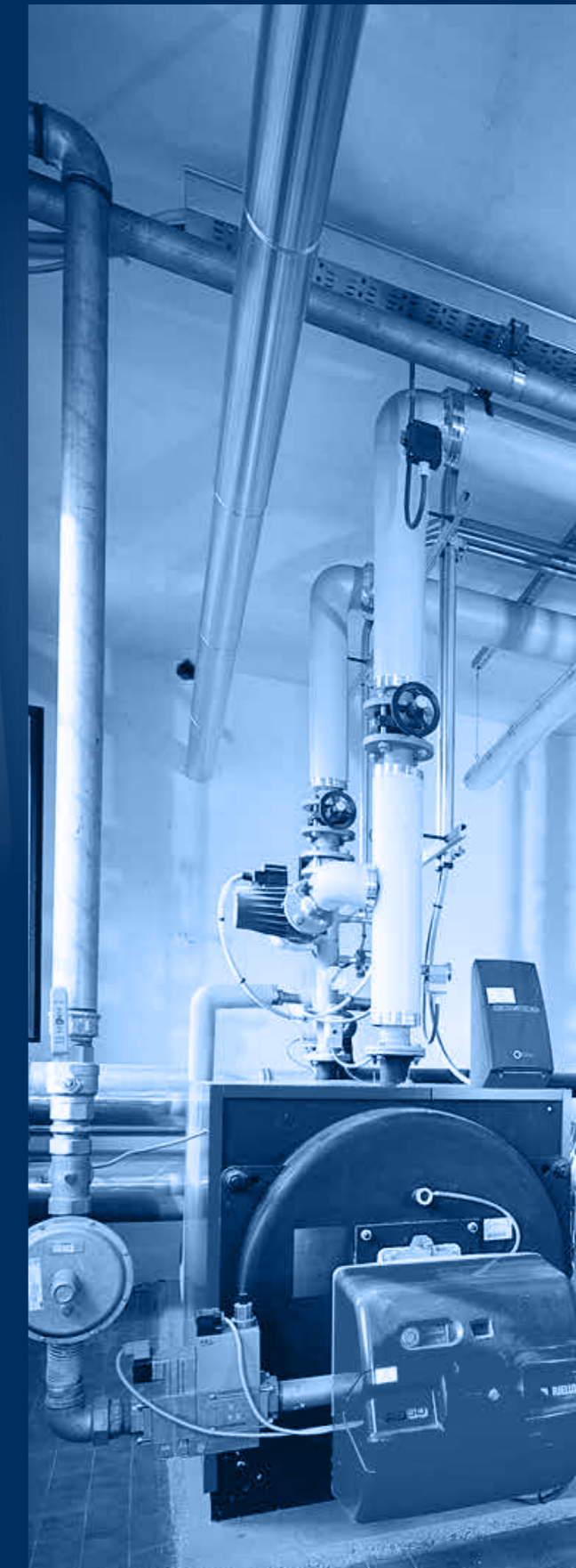
particolare centrale termica / peculiar thermal power plant
