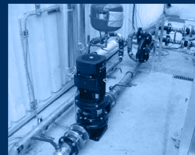
gruppo pompaggio h2O refrigerata / refrigerated water pumping group
