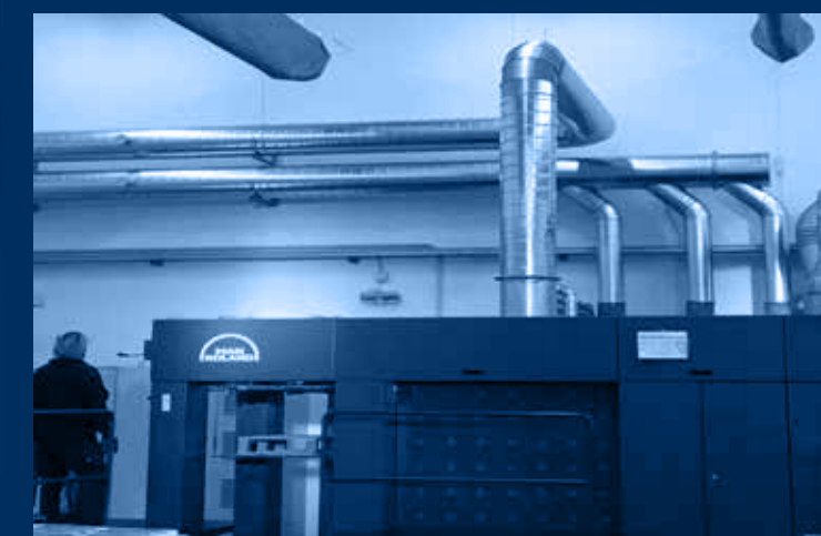
vista punti di captazione interni / internal uptake view
