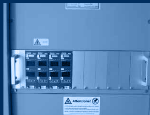
vista unità di controllo / control units view
