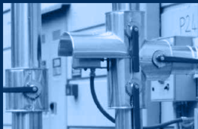
particolare impianto/plant detail
