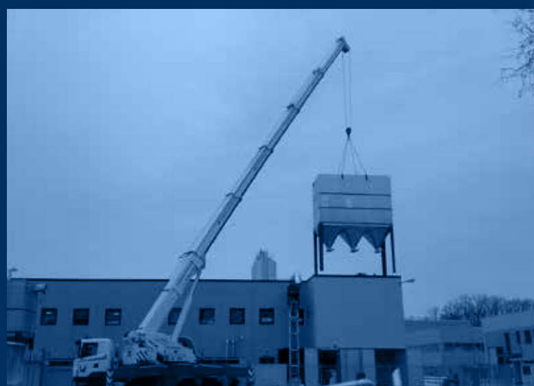
vista globale esterna impianto in fase di realizzo /external global view of the plant under construction
