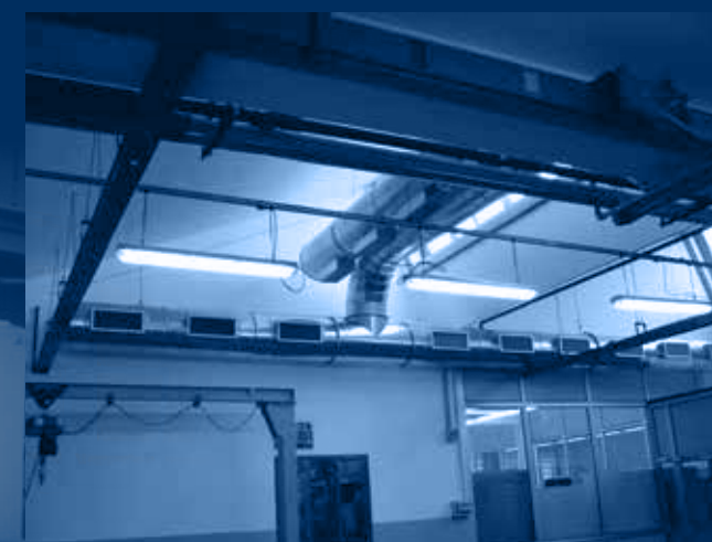
vista interna al reparto con particolare del canale di mandata aria / inside view of the plant with distinctive of the delivery air duct
