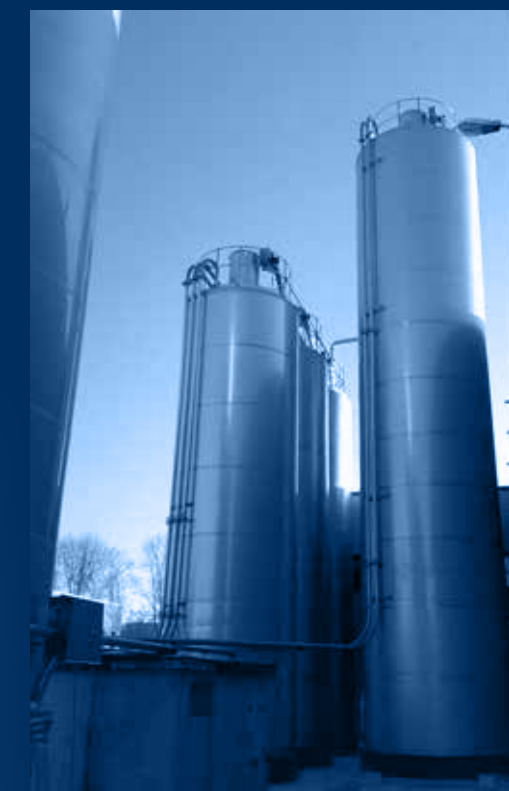
vista impianto esterno in fase di montaggio / external plant in phase of assemblage view
