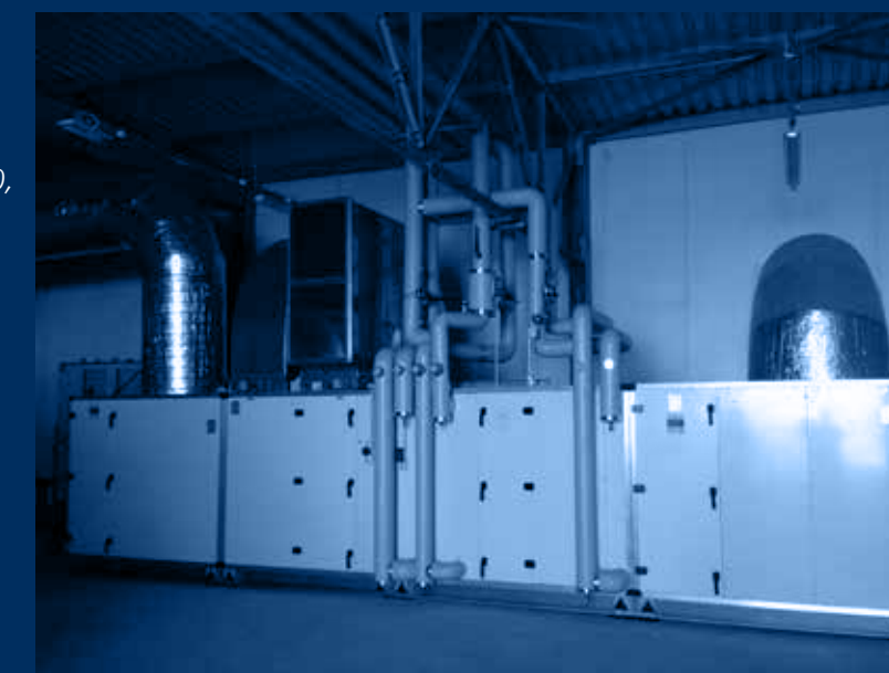
vista unità di trattamento aria /air handling unit view
