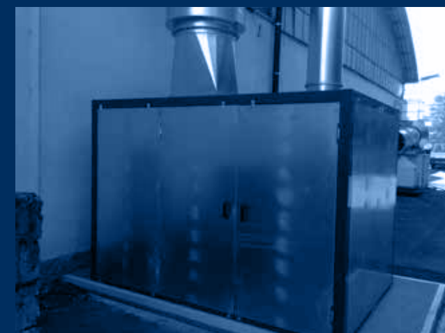
vista box afono ventilatore /soundproofed box view
