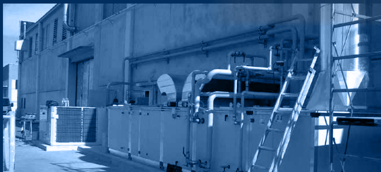
vista globale esterna impianto in fase di realizzo /external global view of the plant under construction
