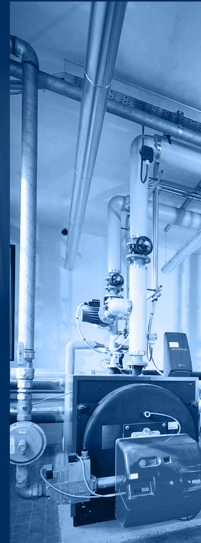
particolare centrale termica / peculiar thermal power plant
