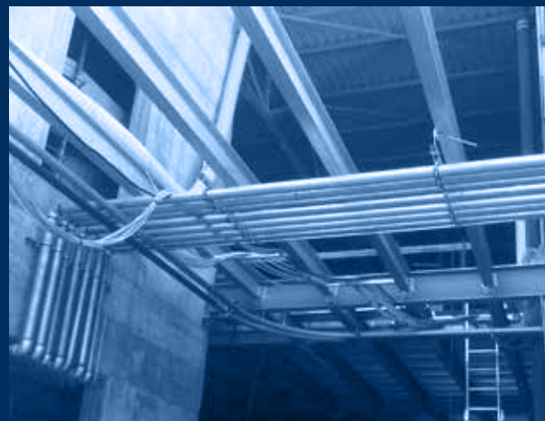
vista linee di distribuzione aria compressa, vuoto, azoto / distribution lines view for compressed air, nitrogen and vacuum
