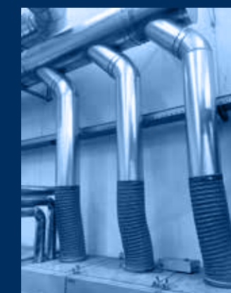
vista punti di captazione interni / internal uptake view
