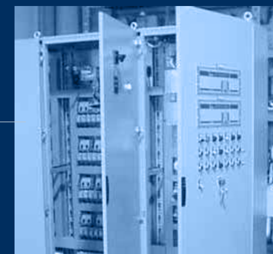
vista quadri elettrici di potenza, comando e controllo UTA/ electrical panels for power, command and control view
