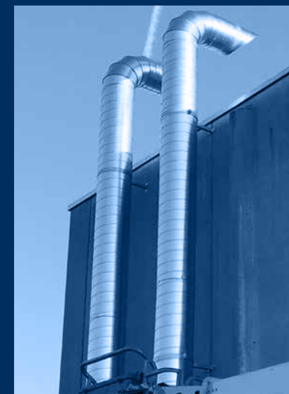
vista camini di evacuazione /emission chimneys view
