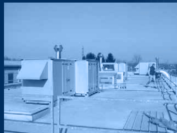
vista unità n°1\2\3/units n°1\ 2\ 3/ view
