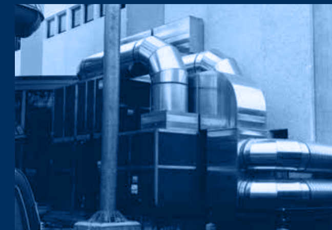
vista centrale e distribuzione d'aria/ central view and air distribution
