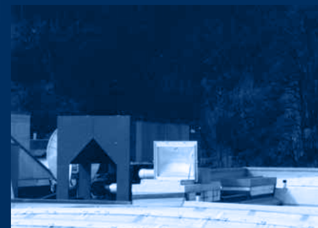
vista refrigeratore in copertura /cooler top view
