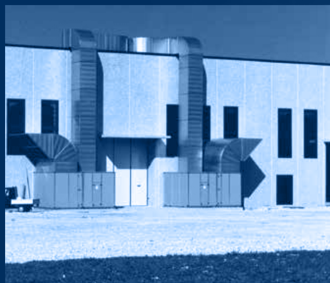
vista centrali e distribuzione esterna / central view and external distribution
