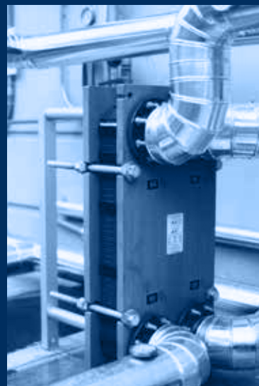
scambiatore h2O/water exchanger
