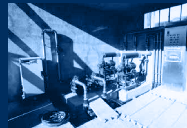
sala macchine - compressori \ pompe quadro elettrico \ analizzatore campionatore/ oxygenation treatment (aerators) \ compressors \ pumps distribution board \ sampler analyzer
