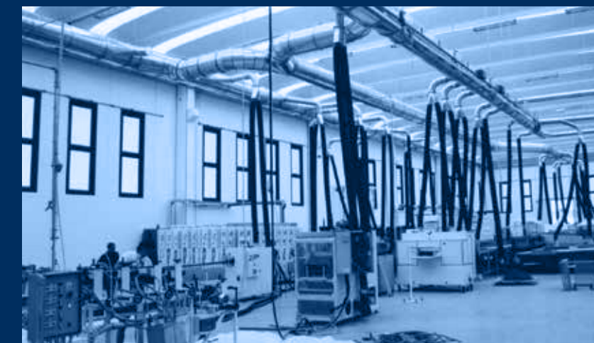
vista impianto interno /inside plant view
