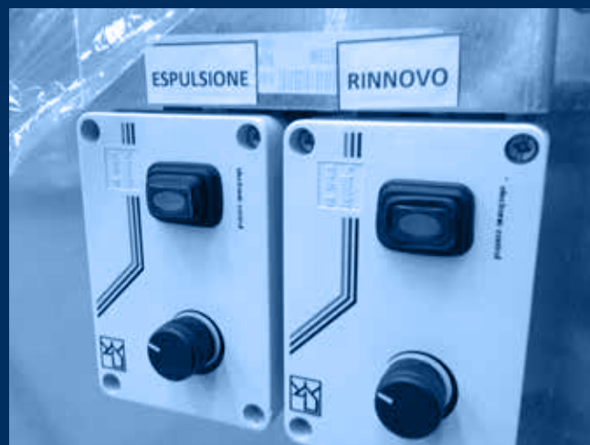
vista comandi di regolazione flussi aria / control panel for air flows regulating view
