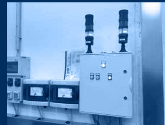
vista quadro elettrico sicurezze e pannelli touch screen di comando e controllo remoto / electrical safety panel and remote touch screen control panels view
