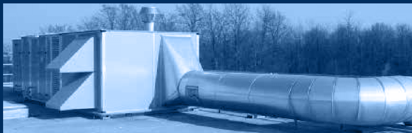
vista frontale unità n°3: canalizzazione mandata aria coibentata con finitura alluminio /front view unit n°3: air delivery canalization cohibented by aluminium finish
