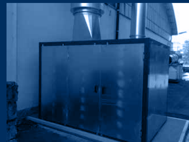
vista box afono ventilatore /soundproofed box view
