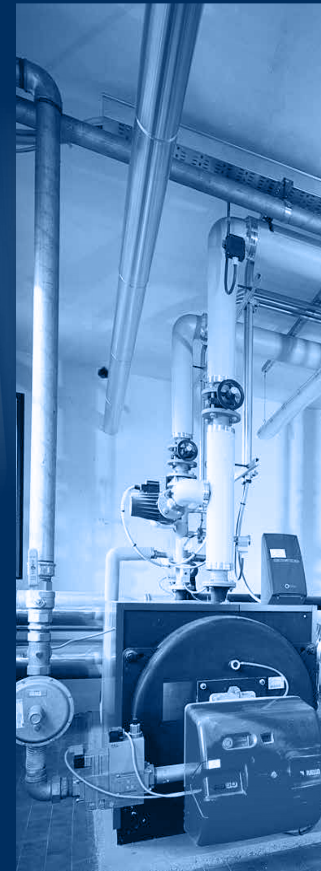
particolare centrale termica / peculiar thermal power plant
