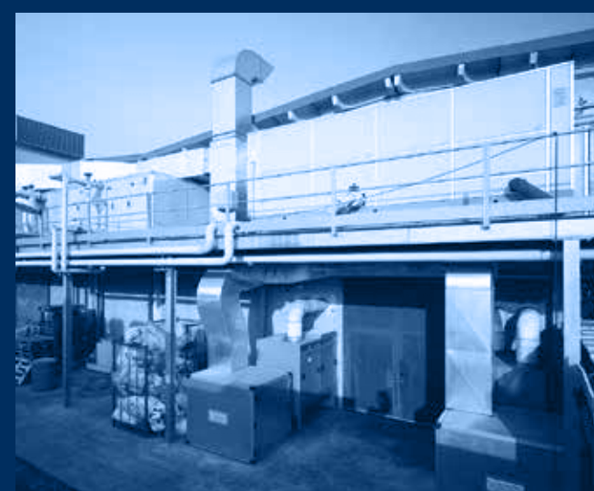
impianti posizionati su soppalco esterno / external plant view
