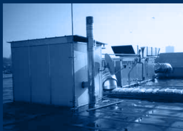
vista impianto completo su copertura / complete plant top view
