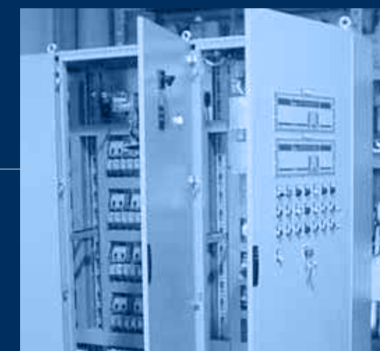
vista quadri elettrici di potenza, comando e controllo UTA/ electrical panels for power, command and control view
