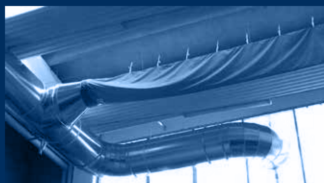
vista interna distribuzione immissione e canale jet-in / internal view of air distributions with jet-in duct
