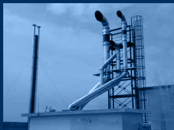
struttura e ventilatori / structure and fans
