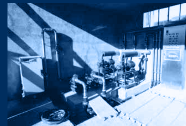
sala macchine - compressori \ pompe quadro elettrico \ analizzatore campionatore/ oxygenation treatment (aerators) \ compressors \ pumps distribution board \ sampler analyzer
