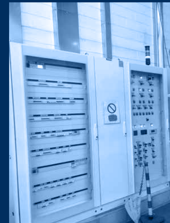
vista quadri centrale potenza e centrale elettronica /power panel and electronic panel view
