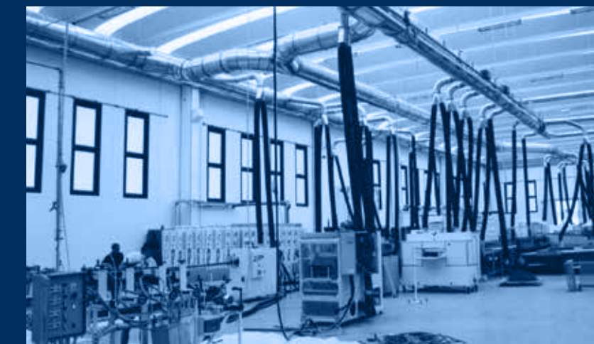
vista impianto interno /inside plant view
