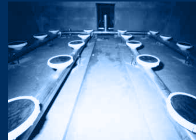
impianto di ossigenazione (aeratori) / oxygenation plant (aerators)
