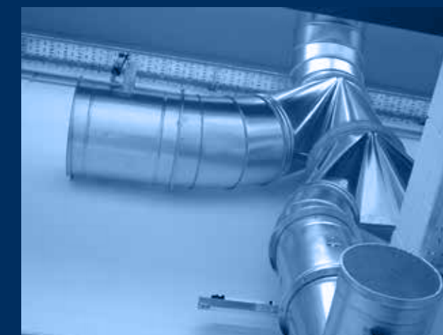
vista canalizzazioni di convogliamento aria / ducts conveying air view
