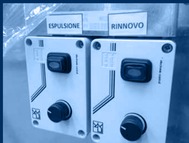
vista comandi di regolazione flussi aria / control panel for air flows regulating view
