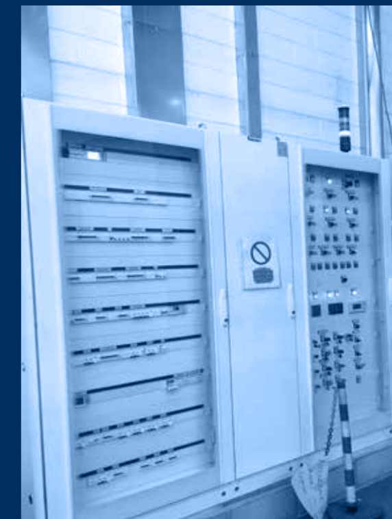
vista quadri centrale potenza e centrale elettronica /power panel and electronic panel view
