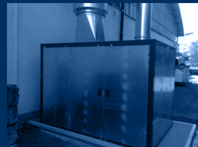
vista box afono ventilatore /soundproofed box view
