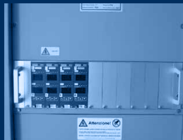
vista unità di controllo / control units view
