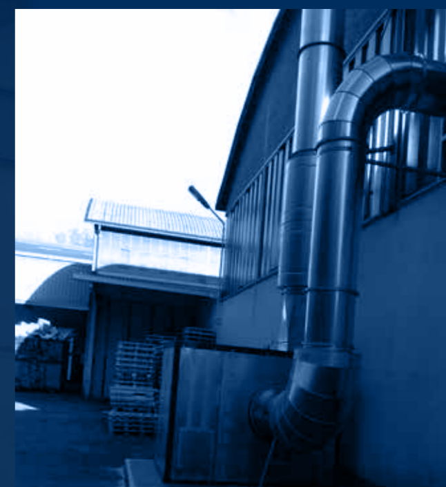
vista box afono e silenziatori / soundproofed box and silencers view
