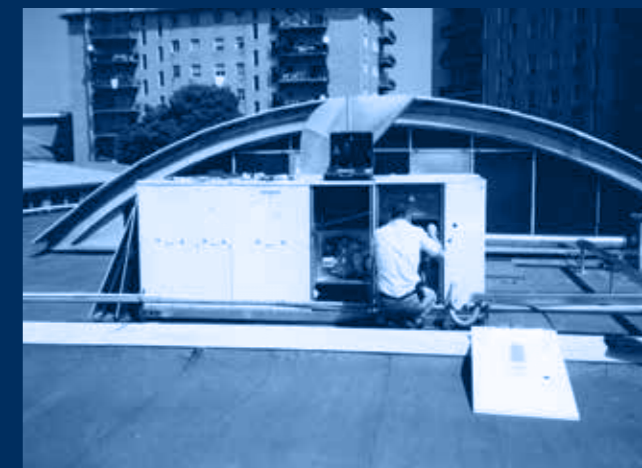
fase di taratura impianto e collaudo / calibration and inspection phase
