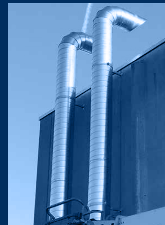
vista camini di evacuazione /emission chimneys view
