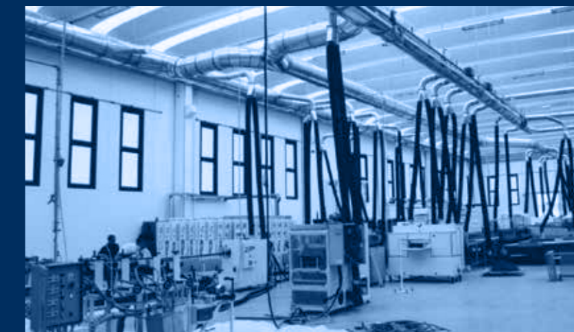
vista impianto interno /inside plant view
