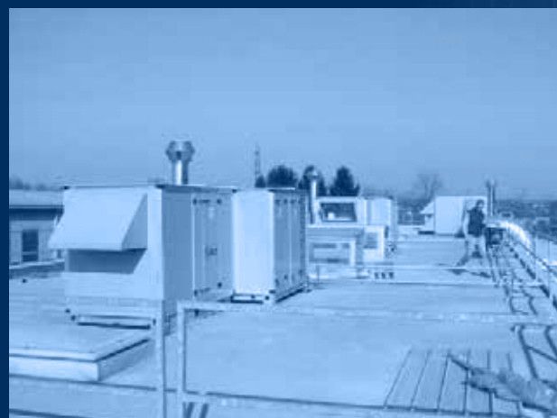
vista unità n°1\2\3/units n°1\ 2\ 3/ view
