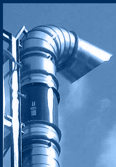
vista ventilatore ATEX e ancoraggio / ATEX fan view and anchorage
