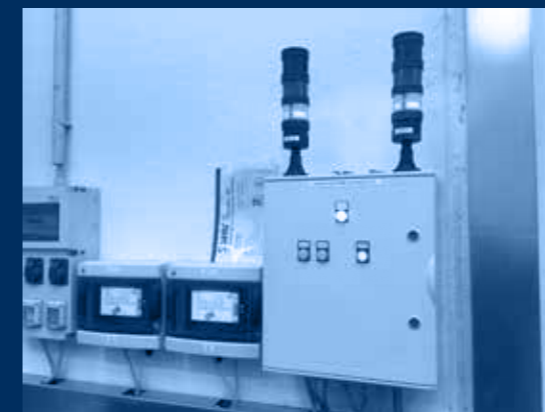
vista quadro elettrico sicurezze e pannelli touch screen di comando e controllo remoto / electrical safety panel and remote touch screen control panels view
