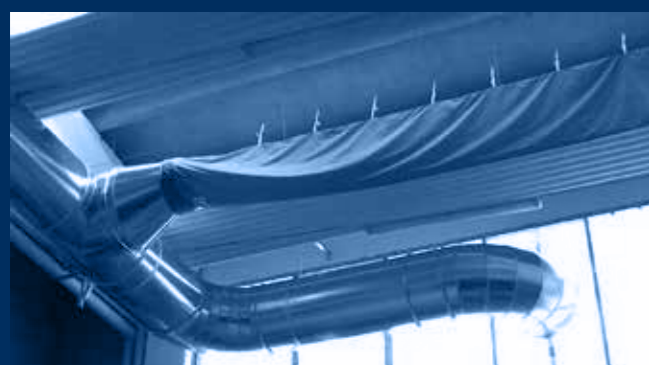
vista interna distribuzione immissione e canale jet-in / internal view of air distributions with jet-in duct
