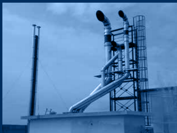
struttura e ventilatori / structure and fans
