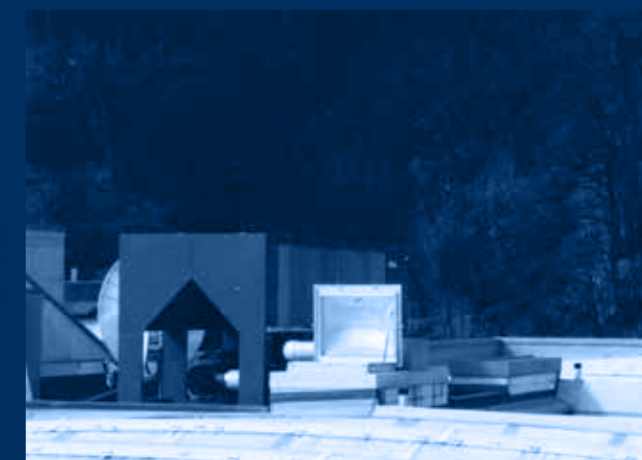
vista refrigeratore in copertura /cooler top view
