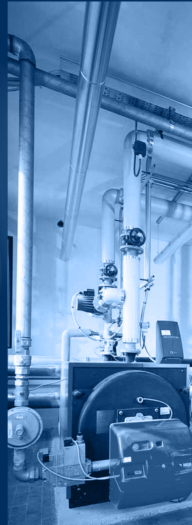
particolare centrale termica / peculiar thermal power plant
