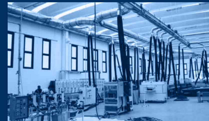
vista impianto interno /inside plant view
