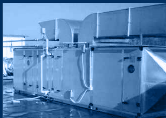
Uta con vista lato attacchi idraulici e ispezioni / air handling unit with hydraulic junctions and inspections side view
