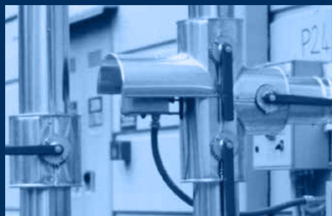
particolare impianto/plant detail
