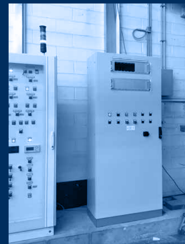
vista quadri rilevazione gas / gas detection panel view
