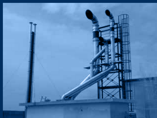
struttura e ventilatori / structure and fans
