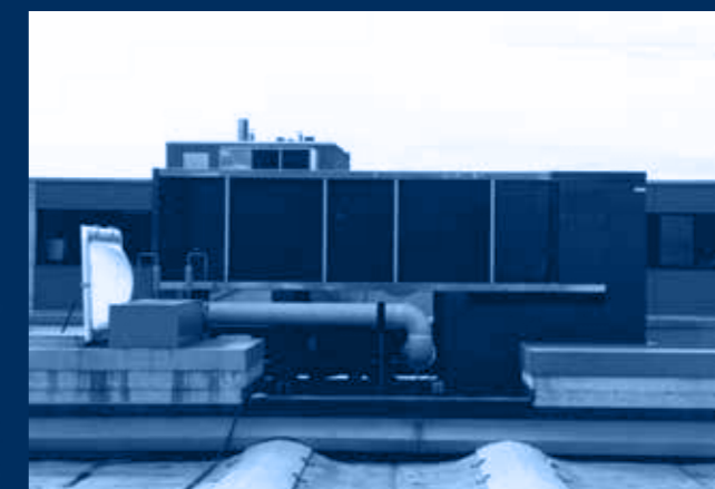
vista frontale condensatore e collettore/ capacitor and manifold frontal view
