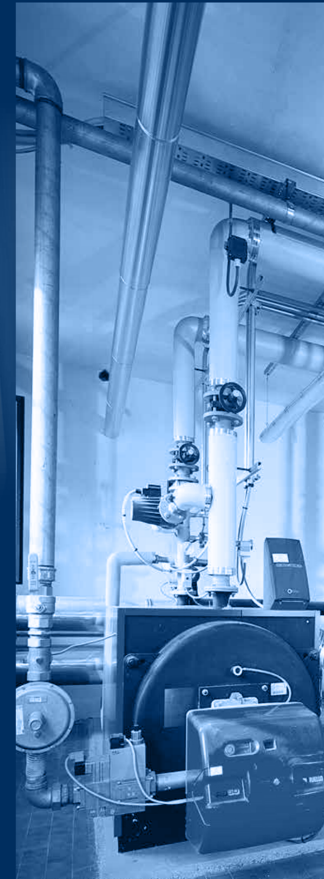
particolare centrale termica / peculiar thermal power plant
