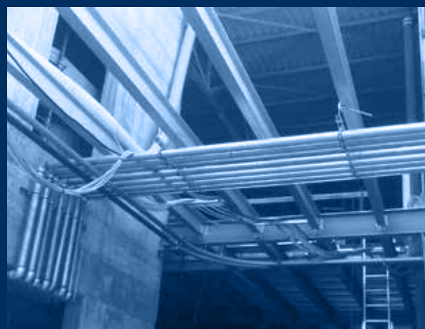
vista linee di distribuzione aria compressa, vuoto, azoto / distribution lines view for compressed air, nitrogen and vacuum
