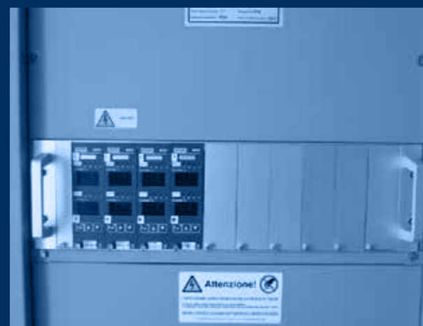
vista unità di controllo / control units view
