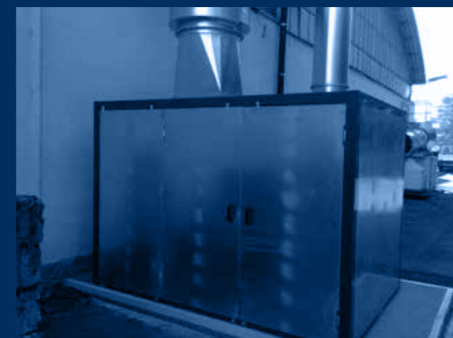
vista box afono ventilatore /soundproofed box view
