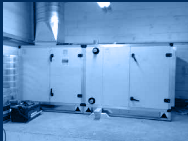
vista UTA posta all'interno del reparto /AHU's view positioning into the department
