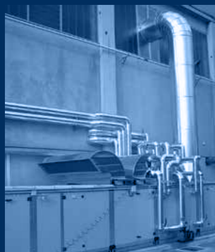
vista UTA sezione camera miscela e distribuzione H2O processo /UTA's mixing chamber and H2O distributions view
