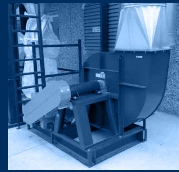
ventilatore aspirazione linea n°1 / suction fan line n°1
