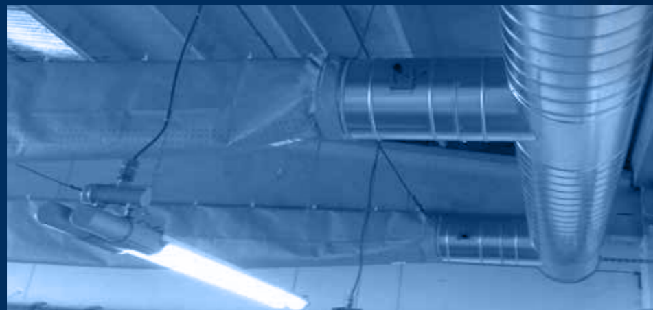
vista distribuzioni jet-in classe 0 e serranda di regolazione\esclusione / jet-in distributions class 0 , and regulation\exclusion damper view
