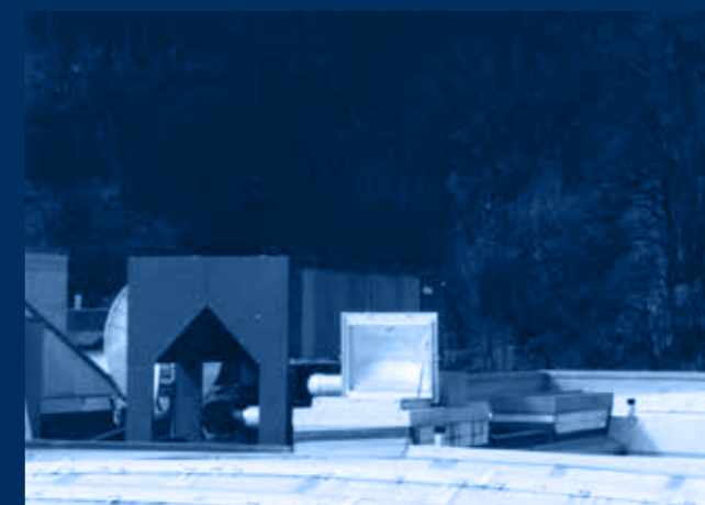
vista refrigeratore in copertura /cooler top view
