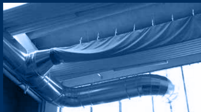
vista interna distribuzione immissione e canale jet-in / internal view of air distributions with jet-in duct
