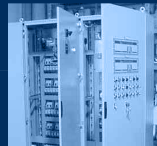
vista quadri elettrici di potenza, comando e controllo UTA/ electrical panels for power, command and control view
