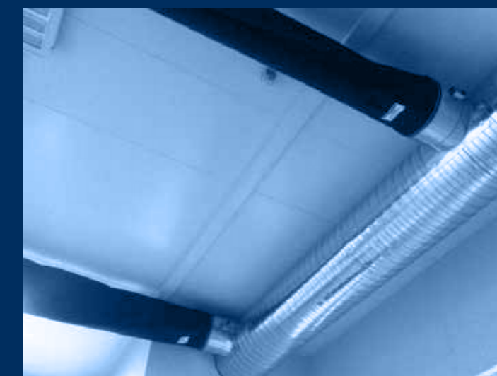
vista canalizzazione JET IN classe 0 /jet in ducts class 0 view
