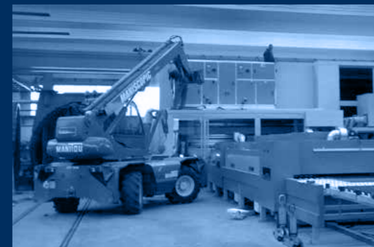
fasi di montaggio UTA deumificazione spinta /assembly stages of UTA pushed dehumidification
