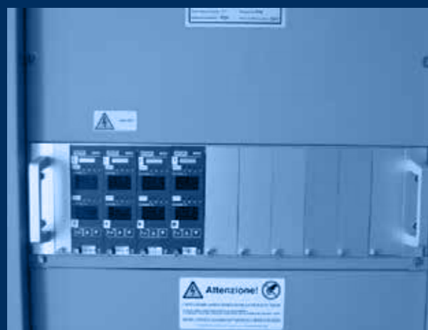
vista unità di controllo / control units view
