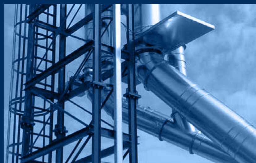
particolare struttura e serrande ATEX / structure and ATEX shutter view
