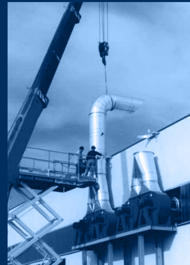
vista impianto esterno in fase di montaggio /external plant in phase of assemblage view
