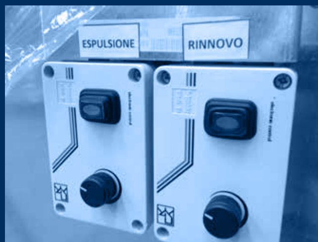
vista comandi di regolazione flussi aria / control panel for air flows regulating view
