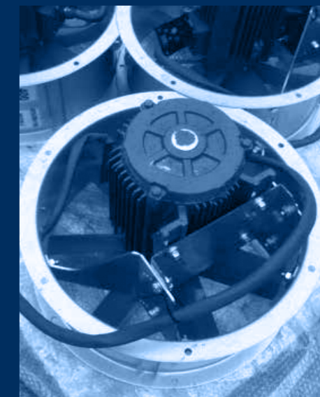
vista ventilatori di estrazione 400°/2h. /extraction fans resistant to 400°C\2h view
