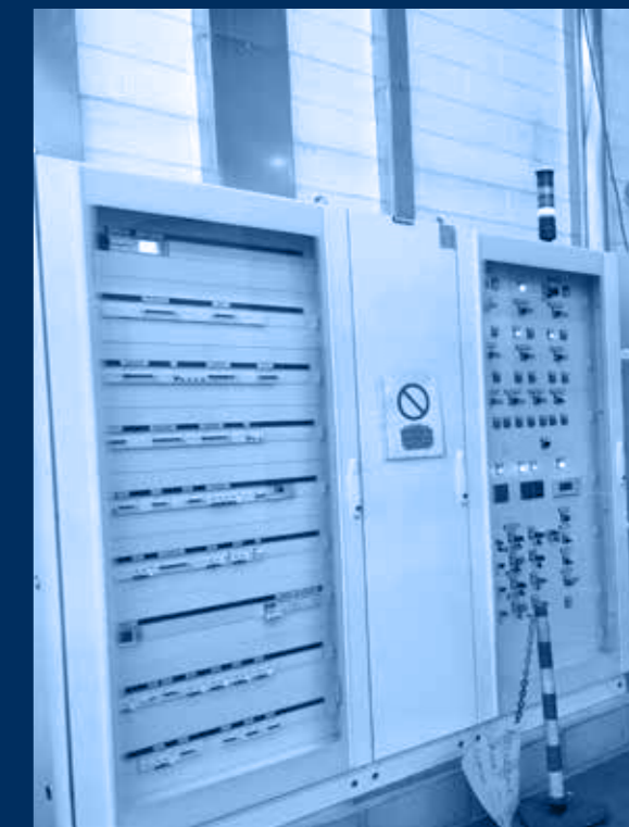
vista quadri centrale potenza e centrale elettronica /power panel and electronic panel view
