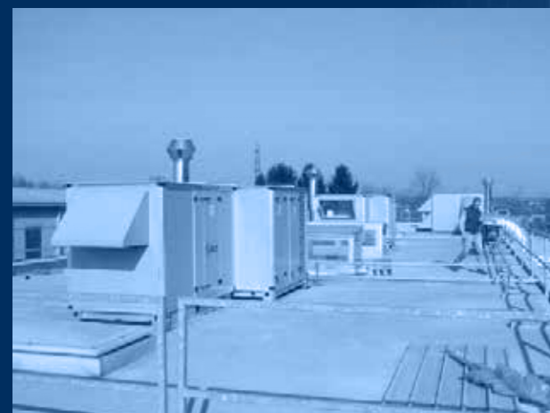
vista unità n°1\2\3/units n°1\ 2\ 3/ view
