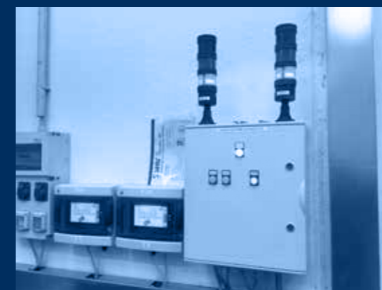
vista quadro elettrico sicurezze e pannelli touch screen di comando e controllo remoto / electrical safety panel and remote touch screen control panels view
